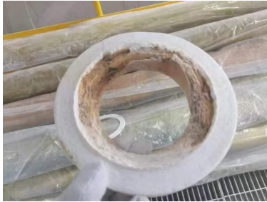
플랜지 변형 또는 파손
